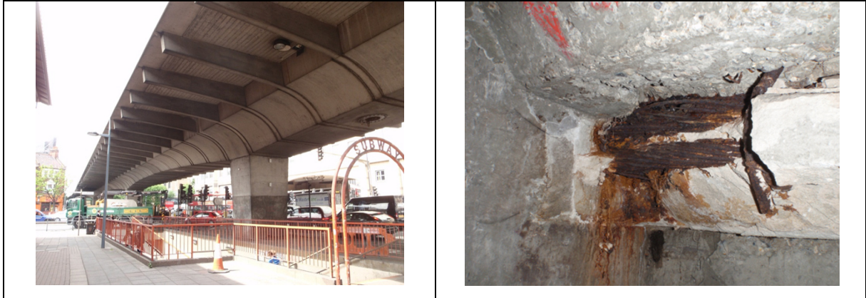
Bild 3. Seitenansicht der „Hammersmith Flyover“ (Bild links) und Korrosion und Bruch an den vollvergossenen Spanndrähten (Bild rechts).
