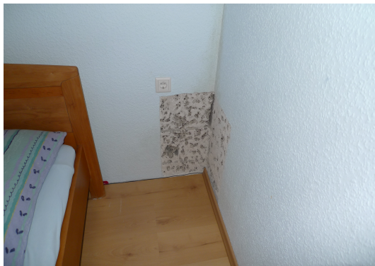
Abbildung 2. Der visuelle Eindruck der schimmelbefallenen Raumecke. Die entfernte Tapete weist auf eine erhebliche Schimmelbildung hin.
