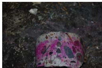
Carbonatisierung erreicht nach weiteren 70 Jahren Standzeit die oberste Bewehrungslage
