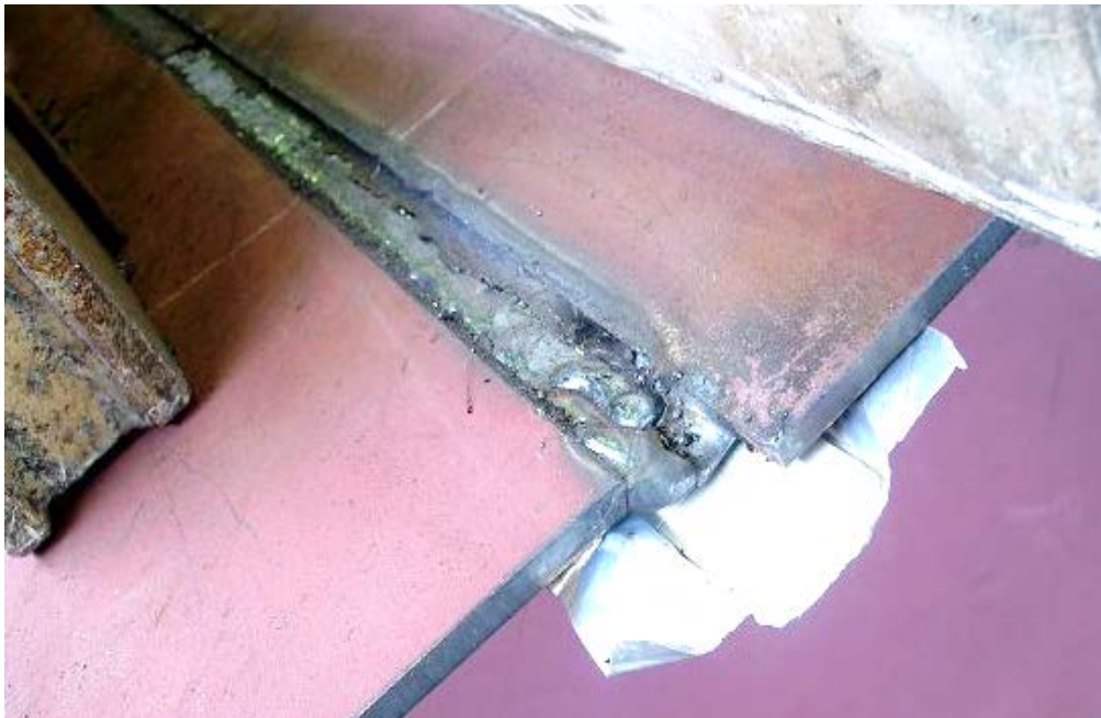
Bild 4. Sichtprüfung während des Schweißens, Riss in Zwischenlage
